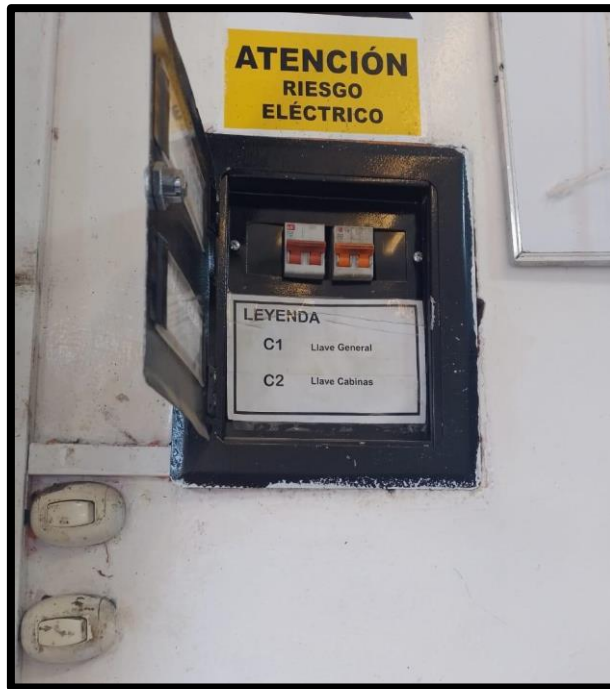
Figura 7. Conexiones y sistema eléctrico
