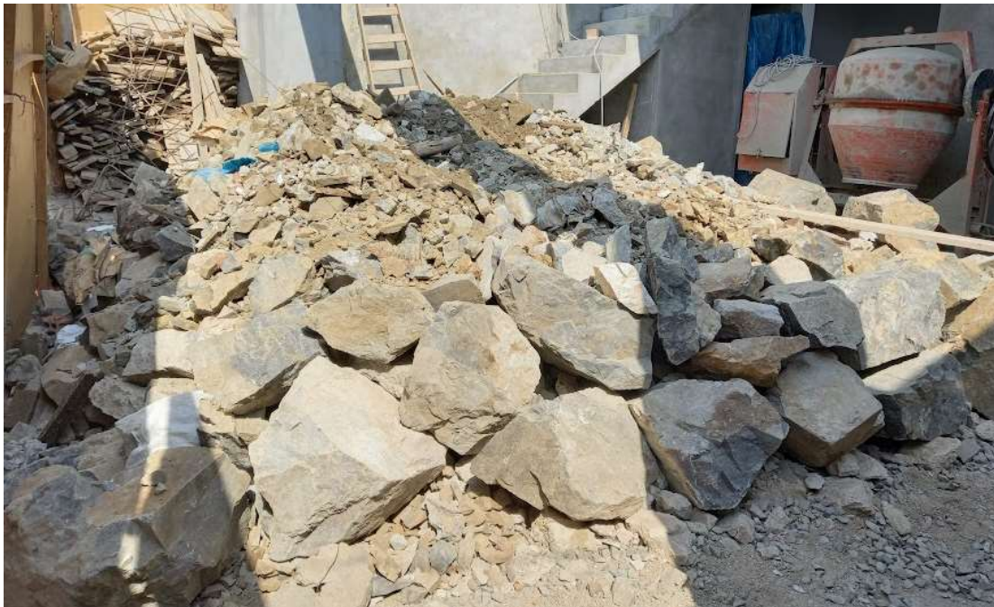
Figura 15: Desmonte y desechos de construcción.
