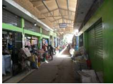
PISOS DE PASADIZOS EN MAL ESTADO, LOS CUALES ESTAN OCUPADOS PARCIALMENTE POR MERCADERIA.
