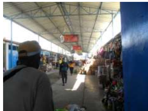
VIAS INTERNAS DEL MERCADO EN MAL ESTADO DE CONSERVACION
