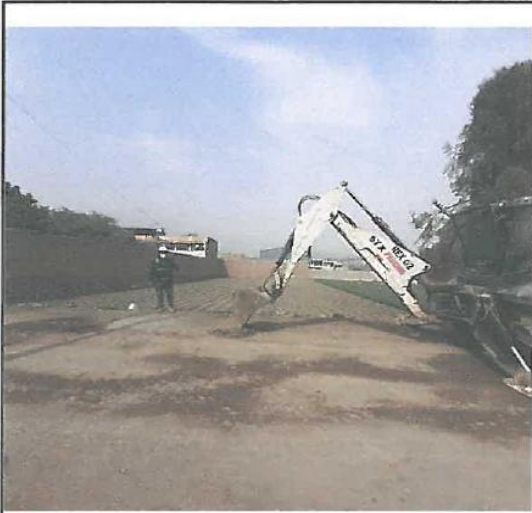
FIGURA N°33 : Ejecucion de la calicata N°2 ubicado entre la Calle Buenos aires y la calle El Portillo.
