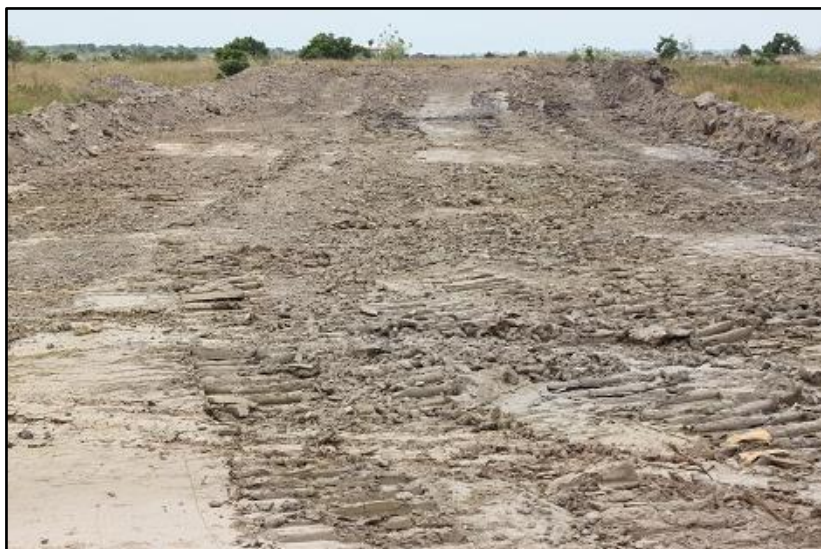
Figura 8. Inestabilidad de suelo cohesivo en una vía
