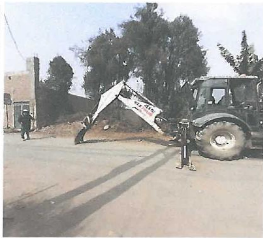
FIGURA N°41 :Ejecucion de la calicata N°3 ubicado entre la calle El portillo y la calle Sauces.
