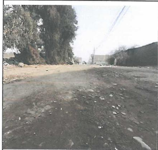
FIGURA N°10 :Se muestra los baches o agujerón en la vía .
