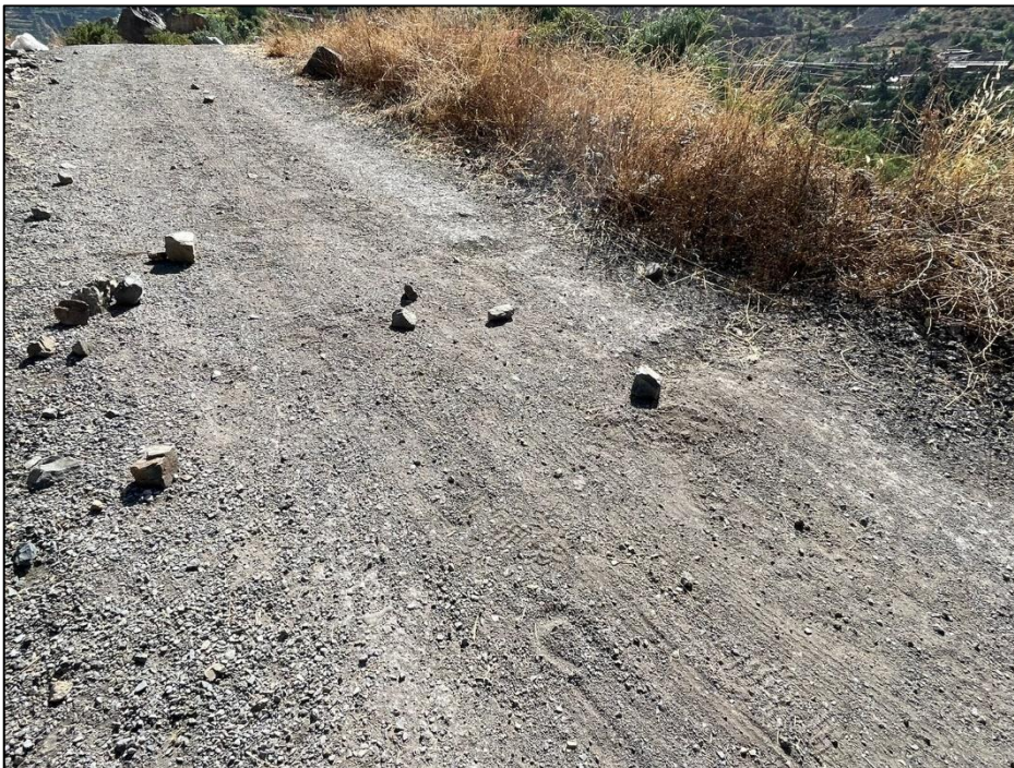
Figura 31: Presencia de piedras en la carretera
