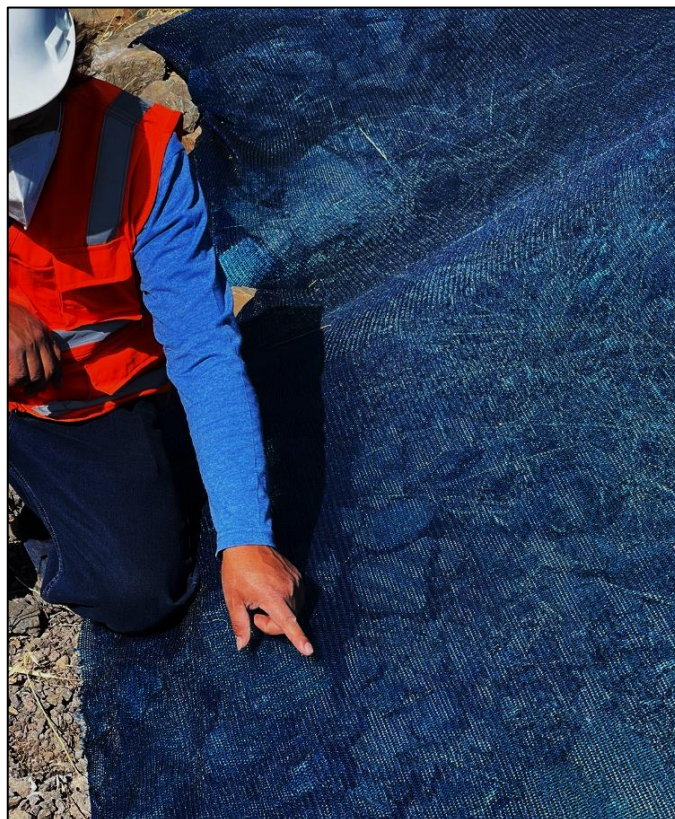
Figura 40: Acumulación de piedras al final del talud
