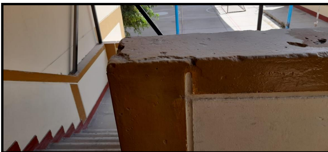
Fig. 9: Muro de escalera con el recubrimiento desboronado.
