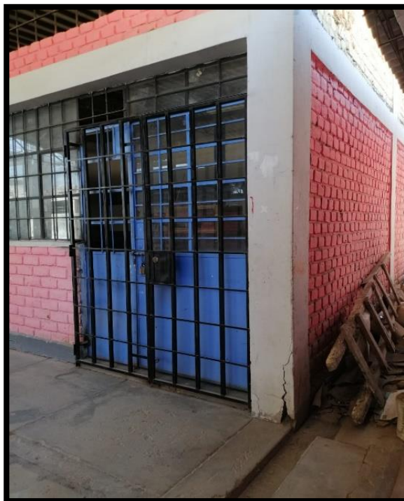
Fig. 8: Fisura en Columna
