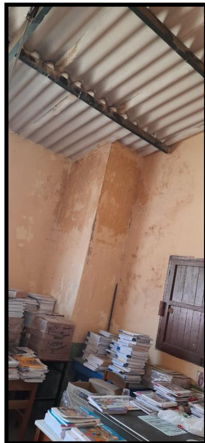
Fig. 6: Presencia de Filtración.
