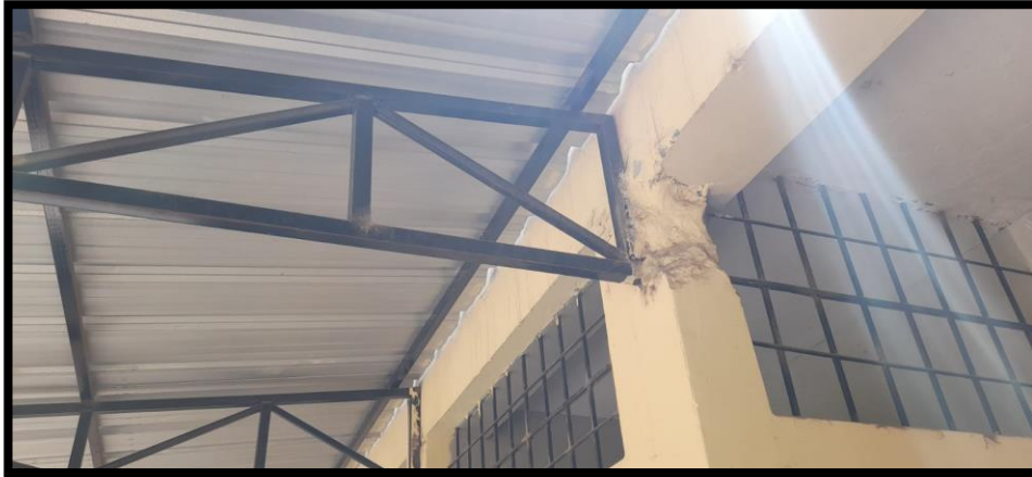
Fig. 2: Columnas con el recubrimiento desboronado.
