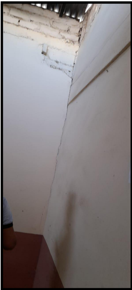
Fig. 5: Muros de albañilería agrietados.
