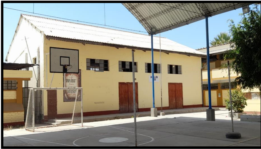
Fig. 4: Con respecto al SUM el muro muestra descascaramiento de pintura, rajadura en encuentro de muro y columna y cimentación expuesta.
