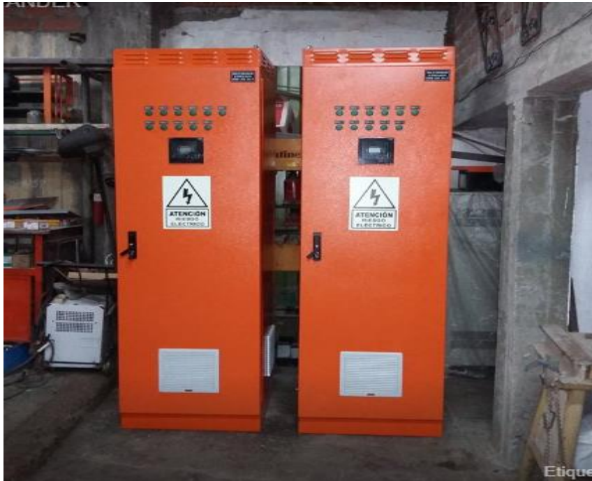
GRÁFICO N°08: Tableros eléctricos de la empresa PROINDELEC SAC
