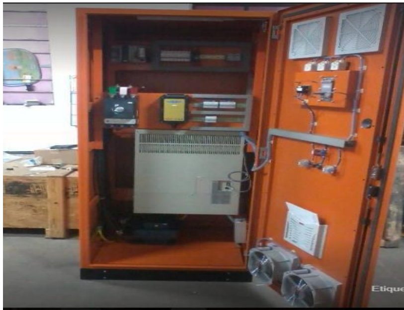
GRAFICO N°09: Componentes de los tableros eléctricos
